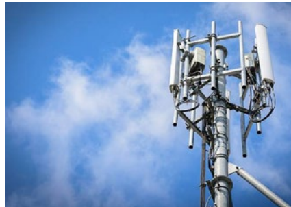
БАЗОВІ СТАНЦІЇ СТІЛЬНИКОВОГО ЗВ'ЯЗКУ
